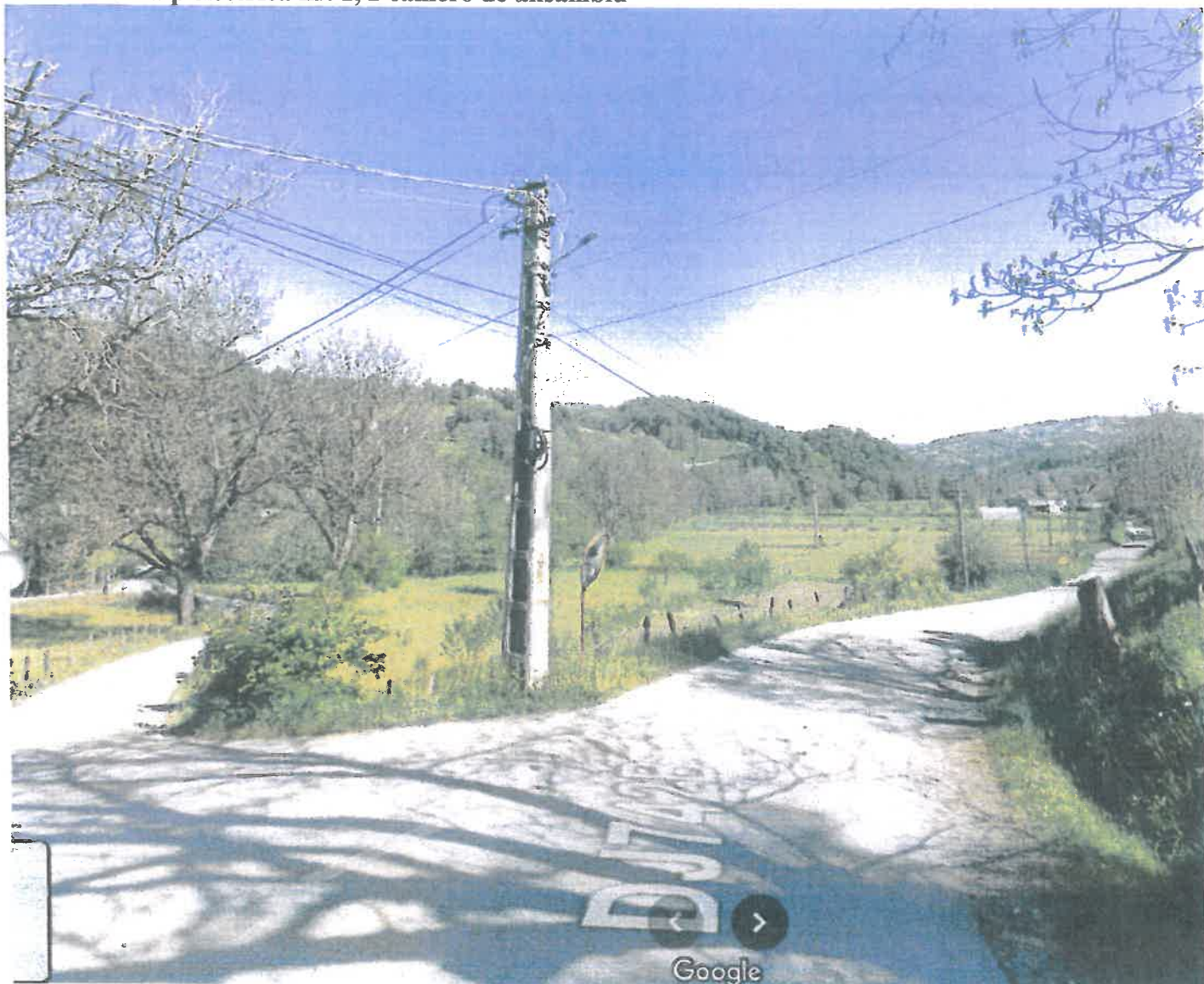
Punctul H stalp electrica nr. 1, 2 camere de ansamblu
