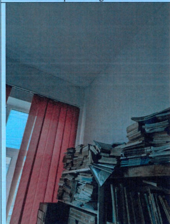
Figura 14. Fisură orizontală perete-planșeu
