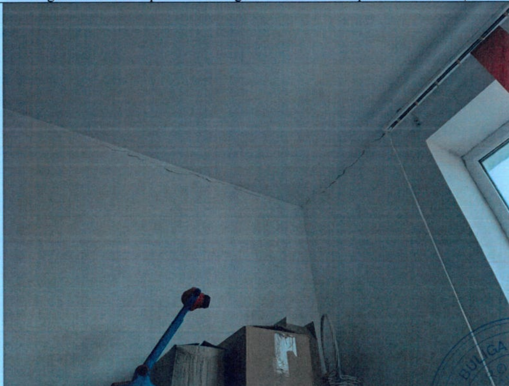
Figura 8. Fisuri orizontale la îmbinarea pereți-tavan
