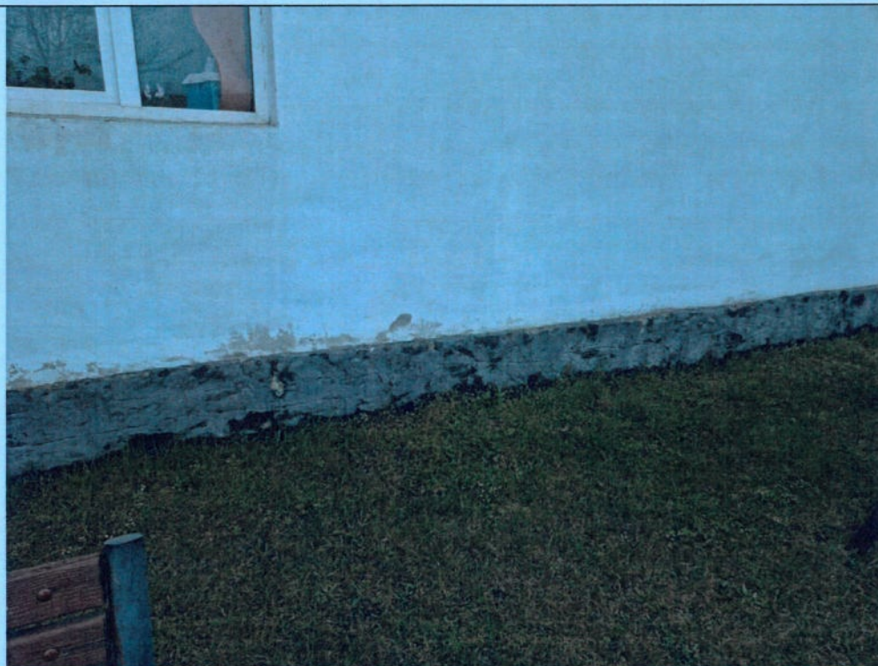
Figura 7. Trotuar lipsă. Zone de igrasie imediat deasupra soclului fundației
