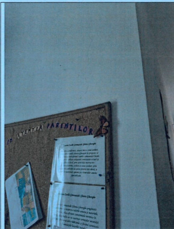
Figura 12. Fisură verticală la îmbinarea perete acces cu perete longitudinal hol
