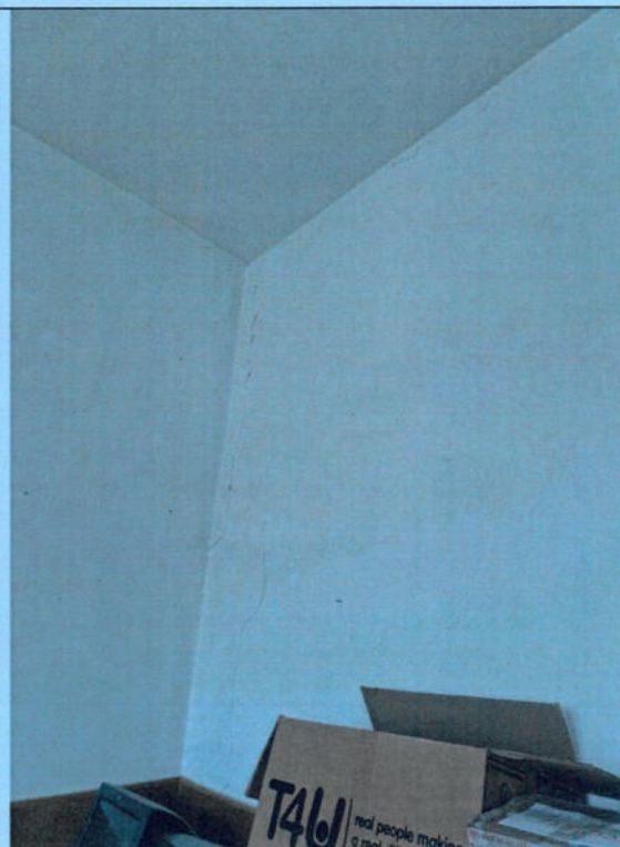
Figura 13. Fisură verticală la îmbinarea perete transversal-perete exterior
