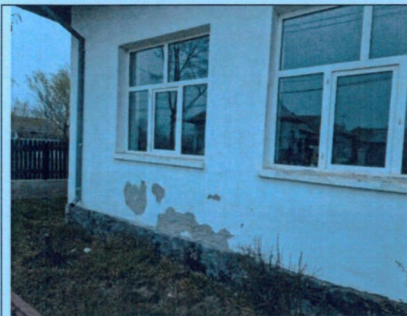
Figura 9. Tencuială degradată și finisaje desprinse din cauza igrasiei generate de apa ascensională
