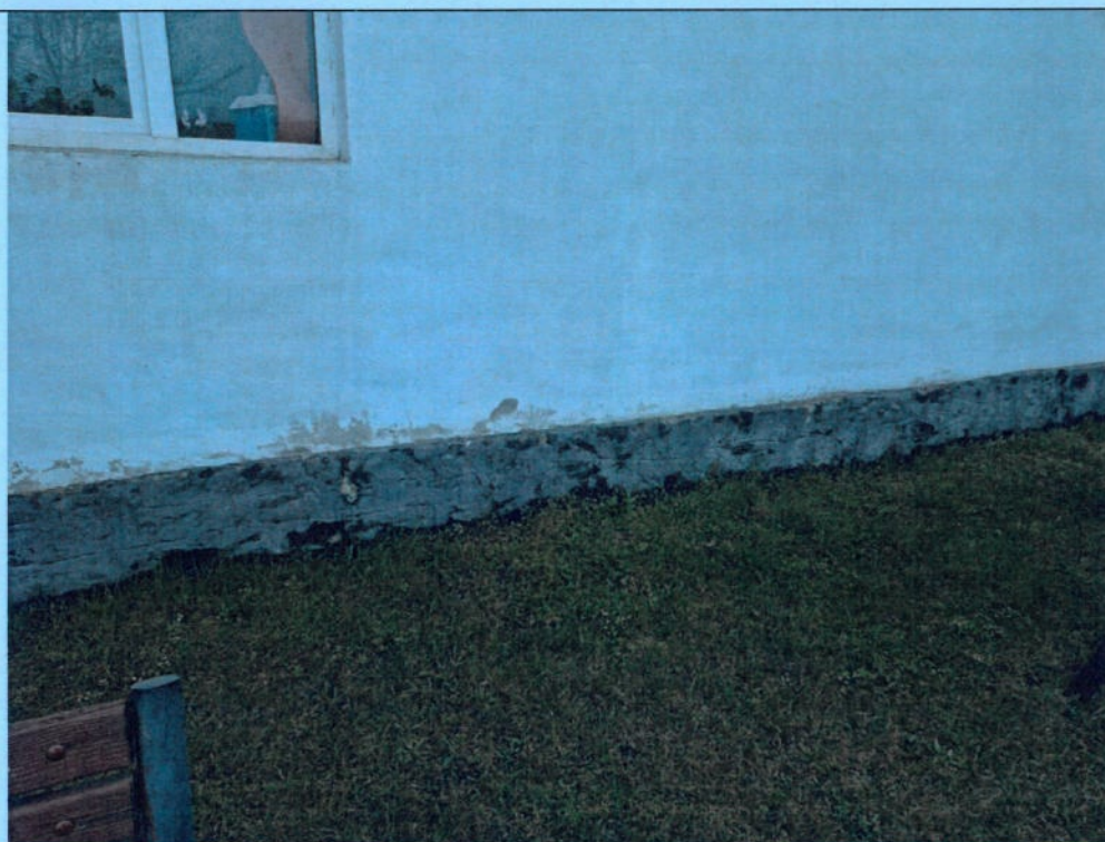
Figura 7. Trotuar lipsă. Zone de igrasie imediat deasupra soclului fundației
