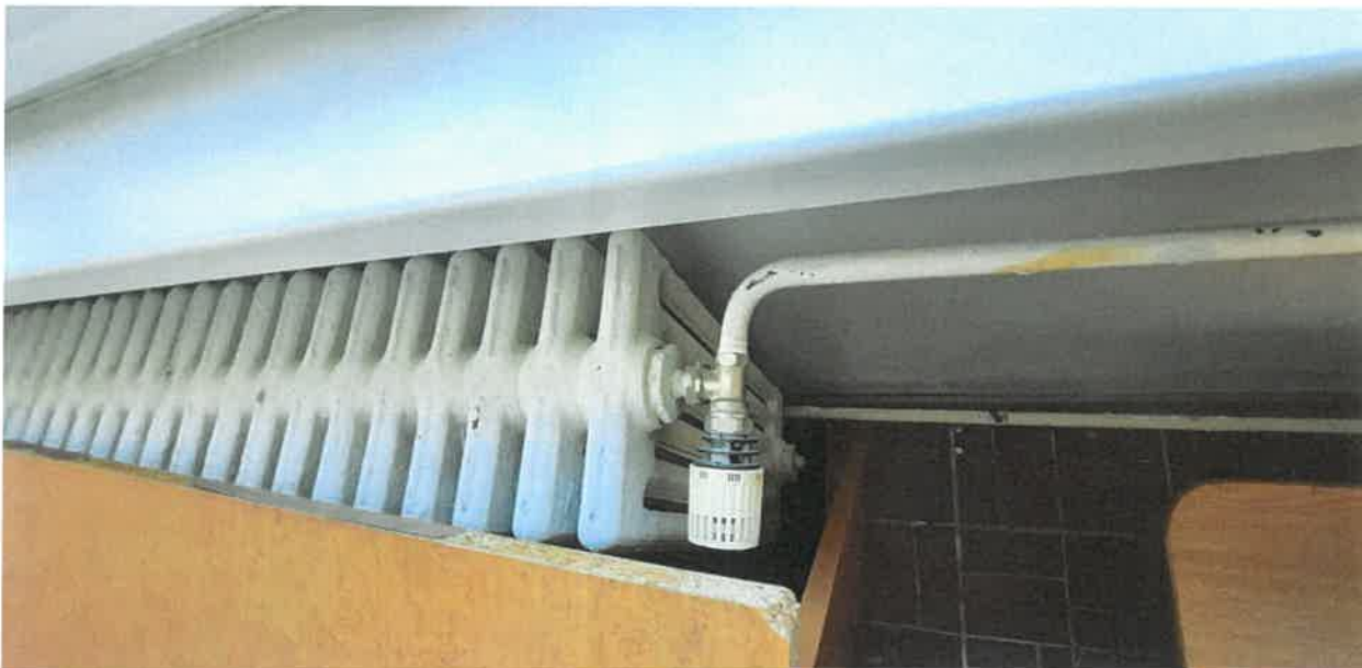
Radiatoare din fonta – existente
