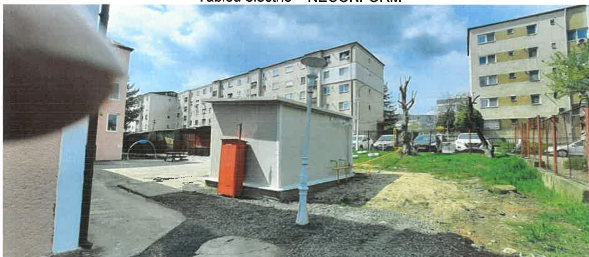
Camera tehnica cu doua centrale pe gaz in condensare – EXISTENTE
