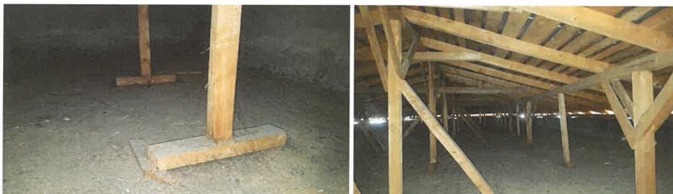
Elemente de acoperis subdimensionate, netratate, si rezemate direct pe termo-hidroizolatia existenta
