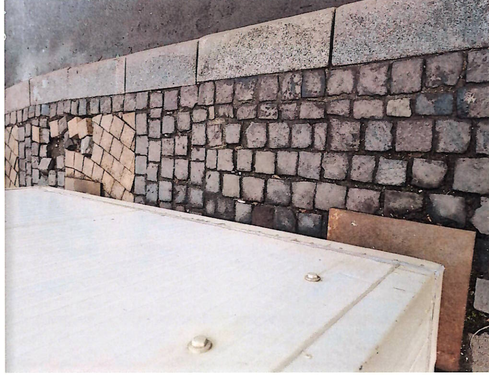
Alternanța piatră cubică și dale de paviment s-a tasat diferit în timp, pe aceeași stratificație de pozare. Rezultatul este deplasarea sau chiar desprinderea lor pe alocuri.
