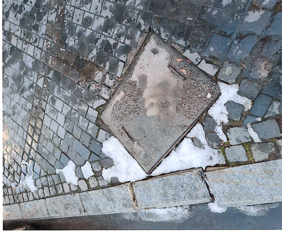
Piatră cubică și dale de pardoseală din andezit recent montate cu stereotomie și sistematizare greșite, care au dus după nici 3 ani de utilizare la desprinderea unor calupuri, a bordurilor și ieșirea din planeitatea trotuarului.
