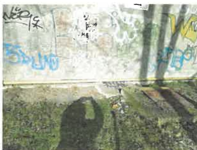
Lipsa trotuar si soclu
