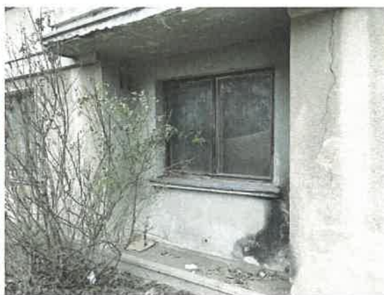
Muchie balcon degradată
