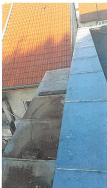
Copertina ultimul etaj cu tabla degradata
