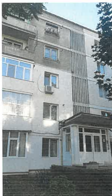
Izolatii partiale neconforme
