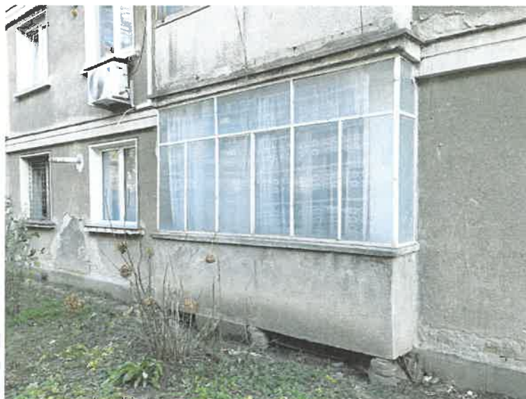
Zona de soclu degradata
