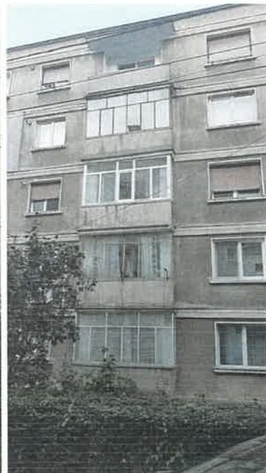
Inchideri balcoane fatada posterioara – neconforme
