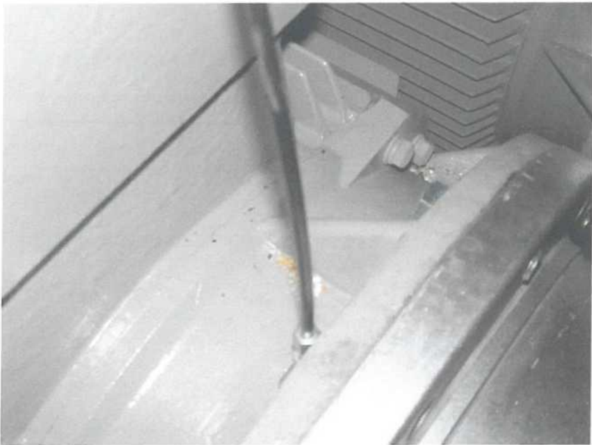
Figura 10: ungere centrala motor electric (partea cuplajului)
