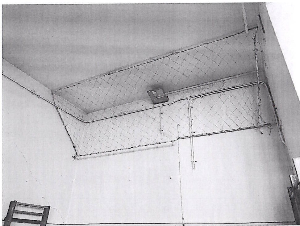
Fig. 9: Vedere interioară colț sud est sală de sport. Fisură înclinată în perete est.
