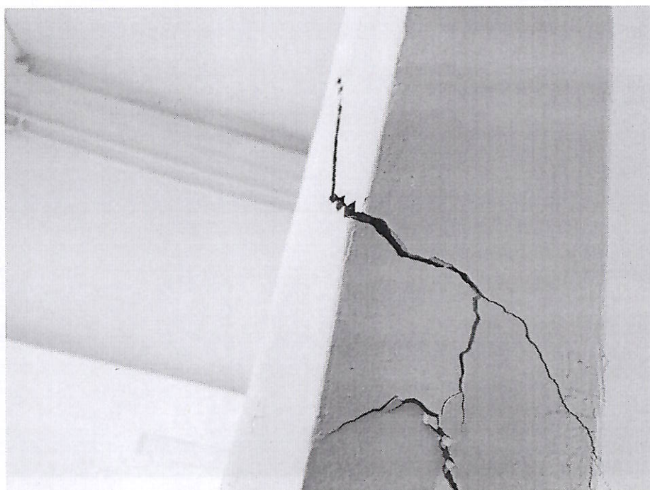
Fig. 15: Detaliu degradări colț perete nord, vedere de pe culoar.
