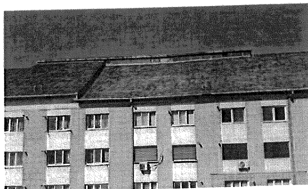
Acoperis - luminatoare sparte
