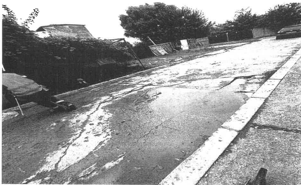
Figura 3.4. Strada nr.3, betonată, gropi, fisuri ale dalelor
