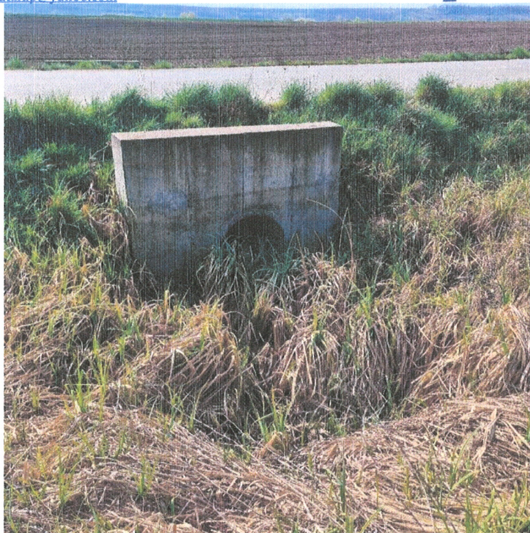
Podeț tubular existent – colmatat, fără lucrări de întreținere
