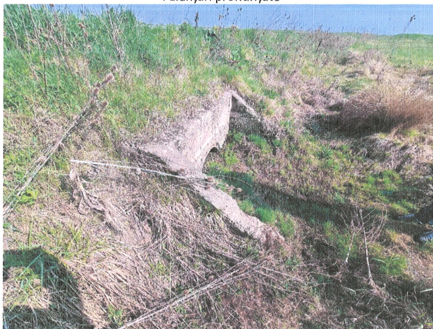
Podet tubular existent – colmatat, fără lucrări de întreținere
