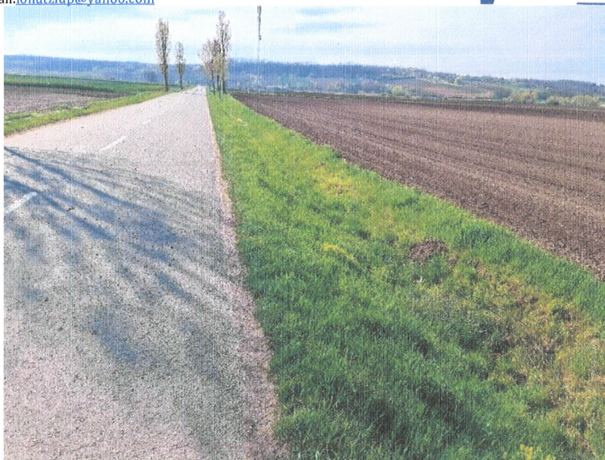
Scurgere defectuoasă a apelor pluviale. Taluz și șanț înierbat
