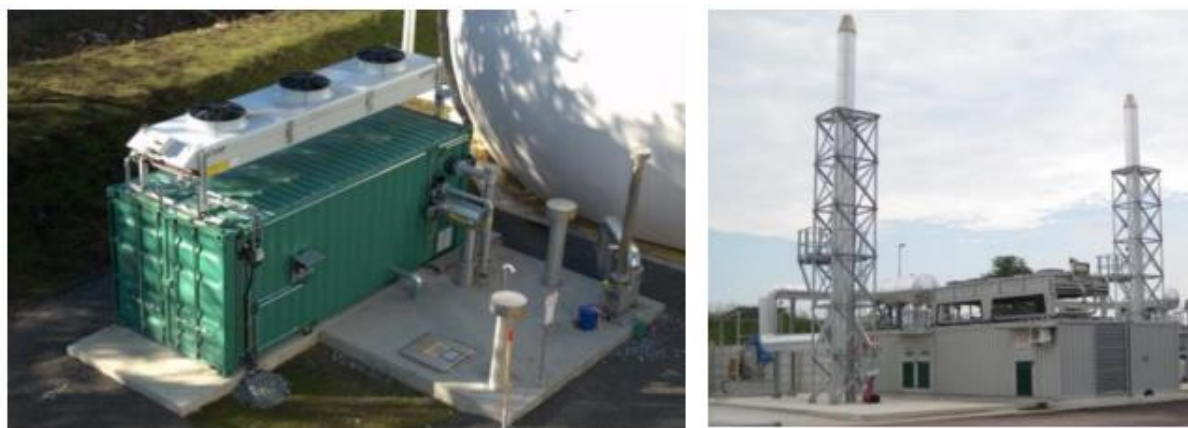
Figură 3-67 Exemplu unitate de tratare a biogazului
