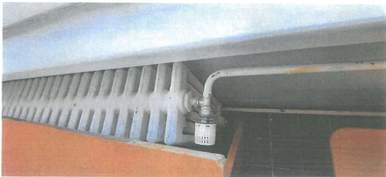
Radiatoare din fonta – existente
