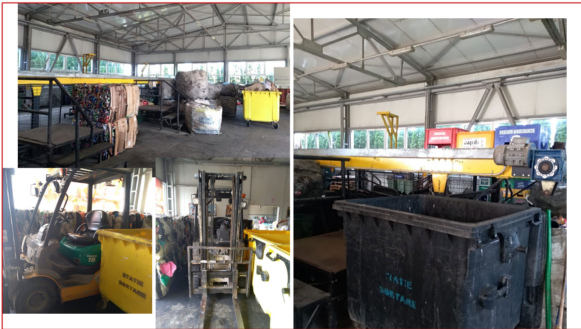
Figura 4-6: Echipamente tehnologice stație de sortare Cumpăna
