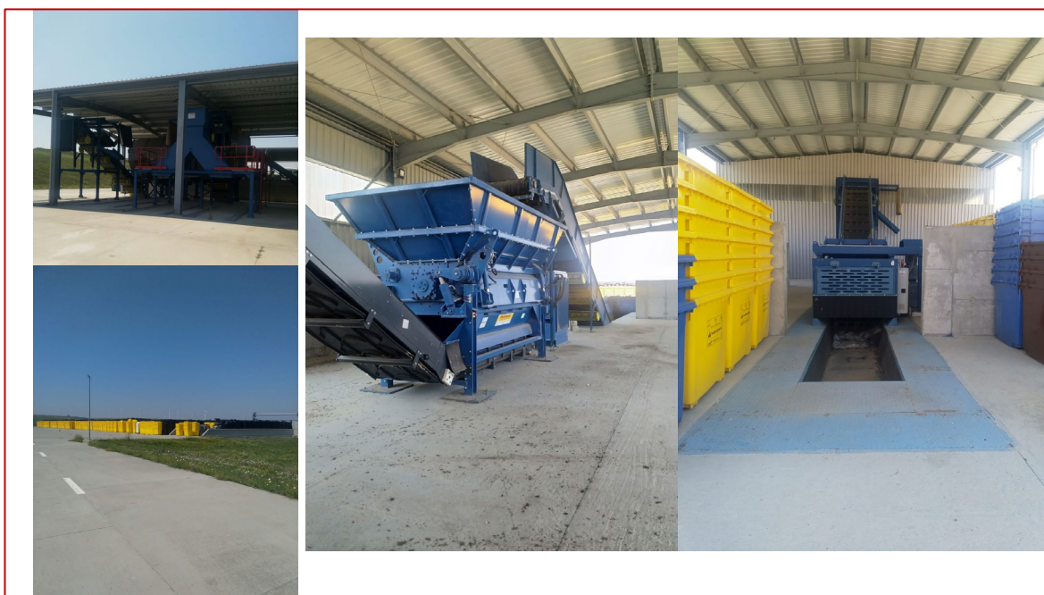
Figura 4-12: Instalației TMB Tortoman
